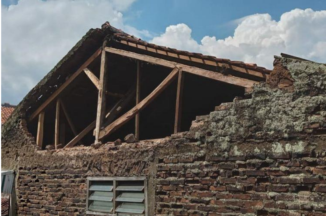
Gambar. rumah runtuh akibat gempa (Sumber gambar : Kompas.com)
