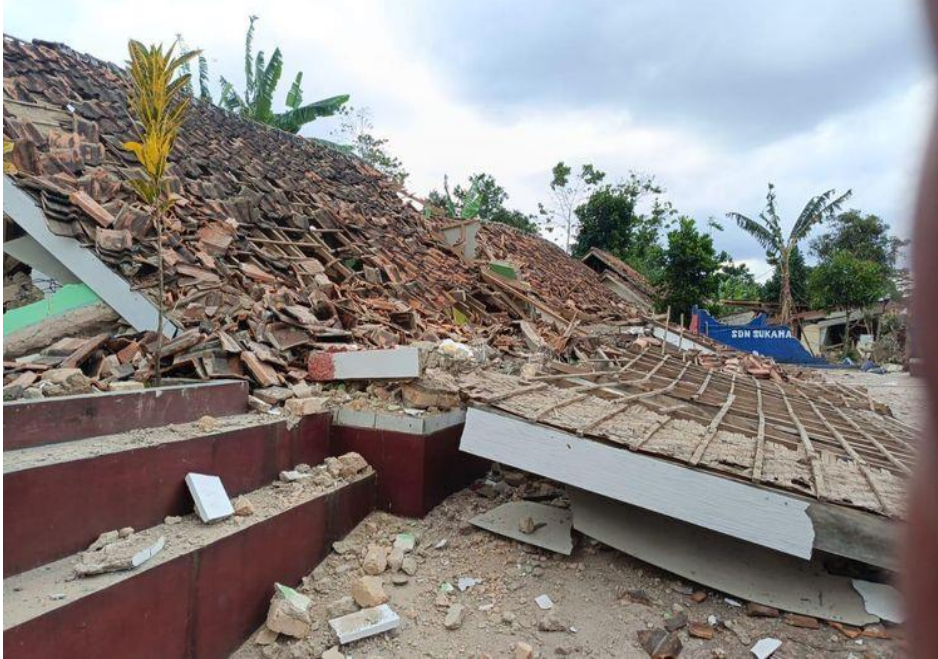
Gambar. Bangunan runtuh akibat gempa (Sumber gambar : Kompas.com)
